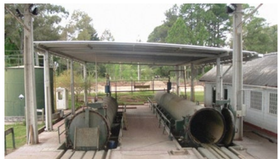
Figura 5. Zona de autoclaves.
